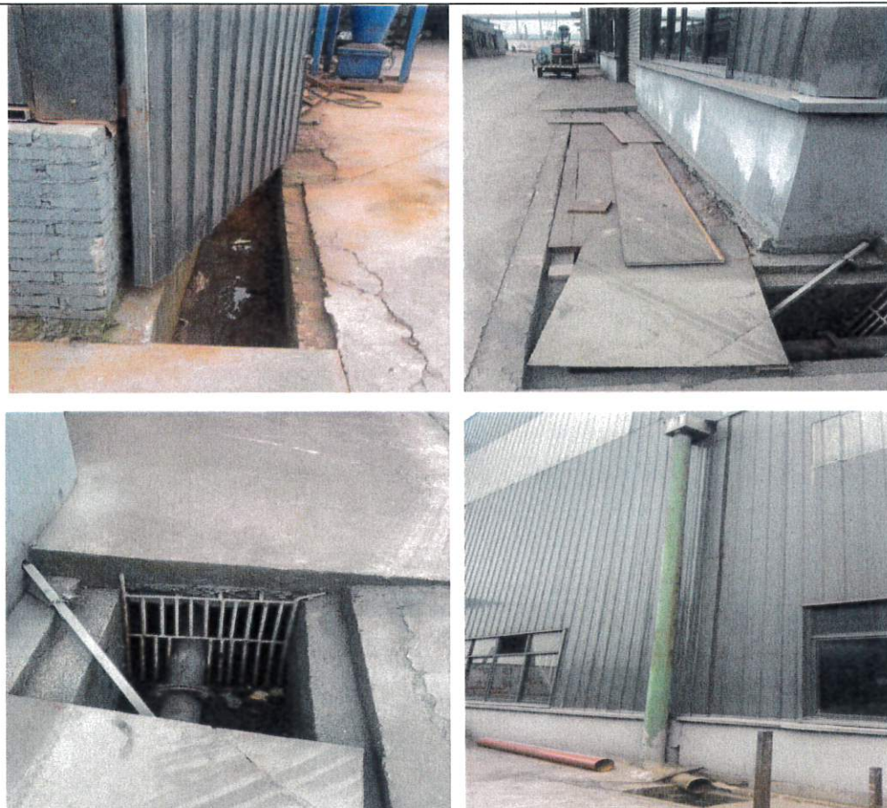
图2 砖砌排水沟现状图
